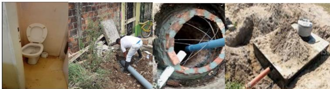
Excusado conectado a pozo ciego
